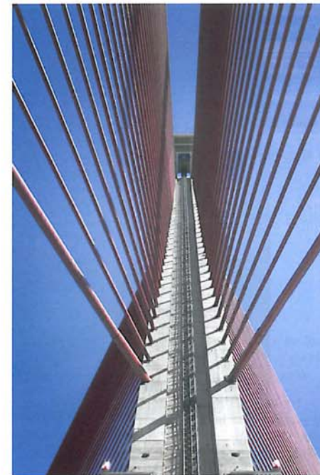
Figura 14. Confluencia de los 4 planos de tirantes en el pylon Figure 14. Convergence of the four planes of stays at the pylon
