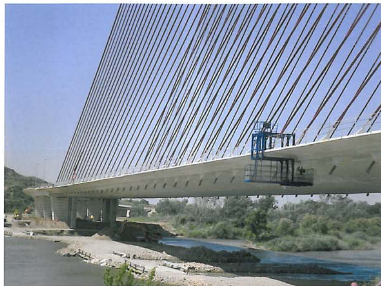
Figura 15. Cesta desde la que se realiza el tesado de los cables de sustentación Figure 15. Man lift for stressing the support cables
