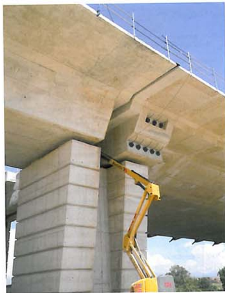
Figura 11. Pila P-1, P-2 y diafragma extremo. Unión del puente atirantado con el viaducto de acceso Figure 11. Piers P-1 and P-2 and end diaphragm. Abutment between cable-stayed bridge and approach viaduct
